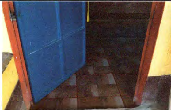
Foto 2: SUSTITUCION PISO A CERÁMICO
