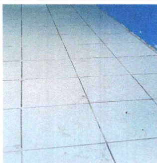
Foto 1: Sustrucción de piso cerámico
