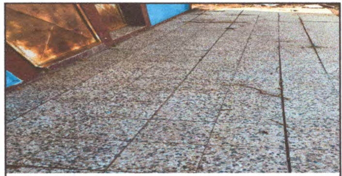
Foto: 6 piso levantado y en mal estado
