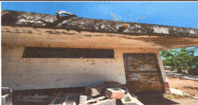
Foto3: puertas en mal estado
