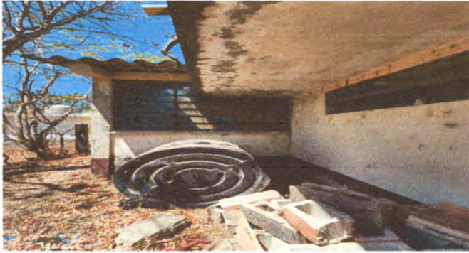
Foto1: Cisterna en mal estado la cual se callo por deterioro
