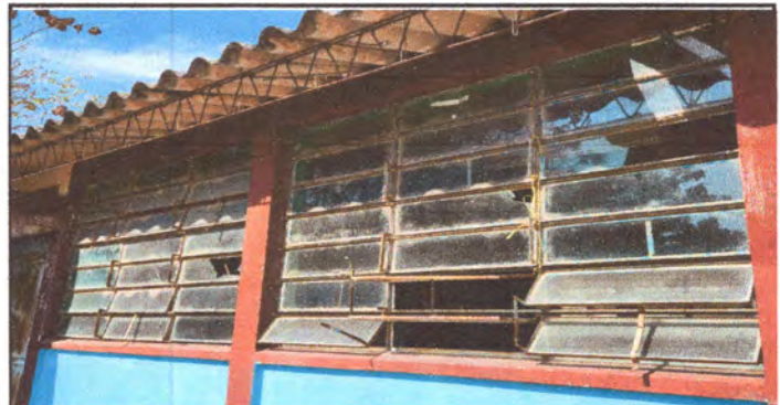
Foto4: Ventanas en mal estado
