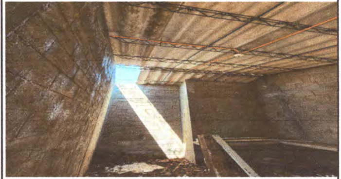
FOTO 2: Estructura y techo en mal estado techo existente duralita
