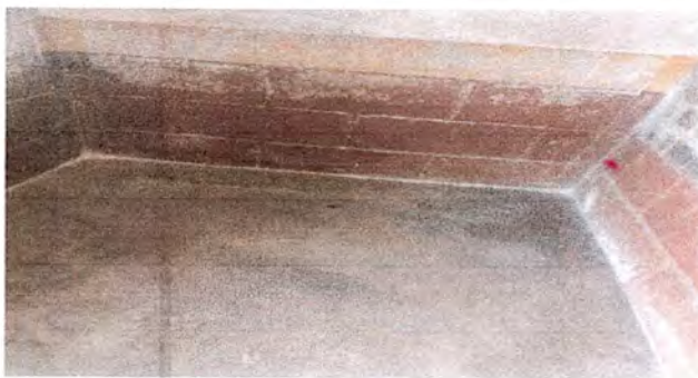
Foto3: Pintura deteriorada de interior y exterior.
