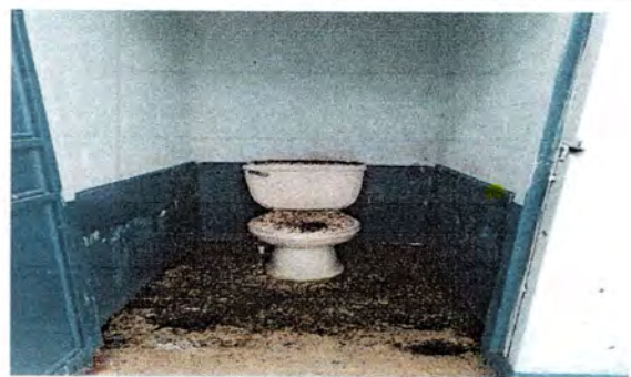
Foto 4: Sanitarios en mal estado.
