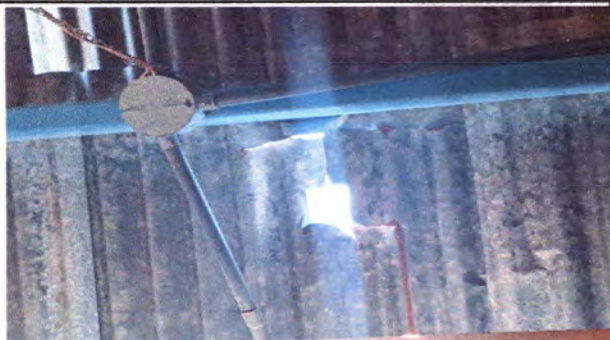
Foto1: Lámina en mal estado con agujeros.
