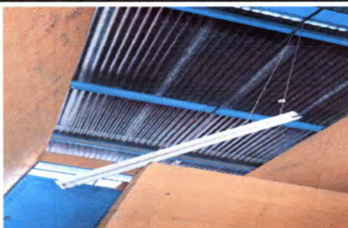
FOTO 8: Lámpara quemadas, en mal estado y en peligro de caerse.
