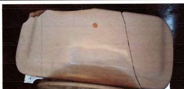
Foto: 6: Sanitarios destruidos.
