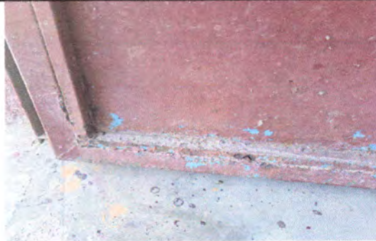
FOTO 2: Puertas oxidadas y corrosionadas.
