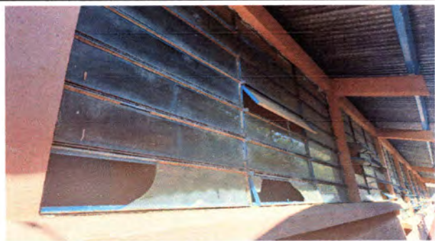
Foto3: Vidrios rotos, flojos y sucios de ventanales.
