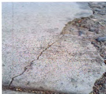
FOTO 10: Losa de patio con grietas y quebraduras.
