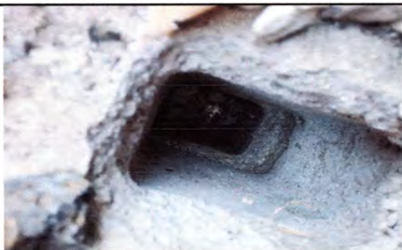
FOTO 9: Red de drenaje y agua potable obstruidas.
