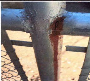
FOTO 7: Portón de entrada corrosionado.
