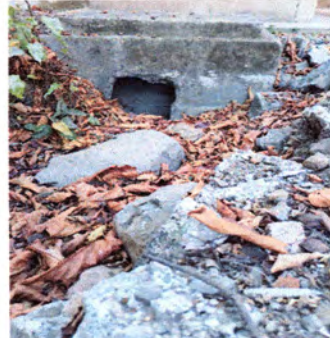
Foto4: Cunetas obstruidas y en mal estado.
