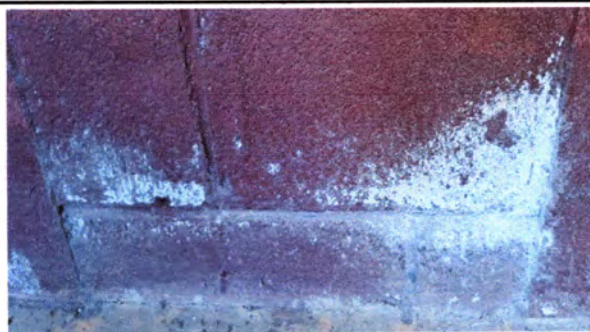
Foto: 5: Pintura deteriorada de interior y exterior.
