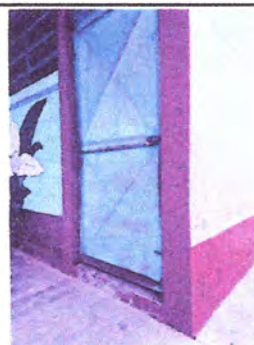
Foto4: Puertas en mal estado
