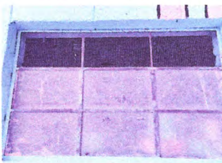
Foto3: Ventana en mal estado
