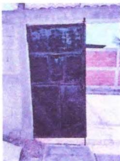
Foto1: Porton de ingreso al establecimiento en mal estado
