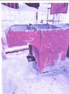
Foto: 5 Pila vieja la cual ya esta en mal estado
