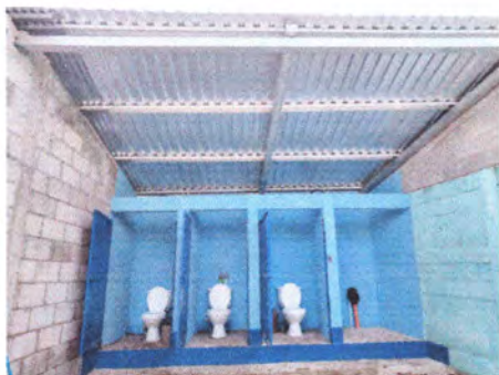
FOTO 1: SERVICIOS SANITARIOS Y SUS ACCESORIOS
