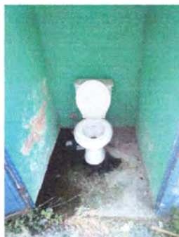
FOTO 1: SERVICIOS SANITARIOS Y SUS ACCESORIOS
