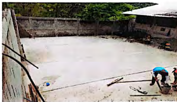
Foto 2: loza de patio entrada principal Edificio de parvulos
