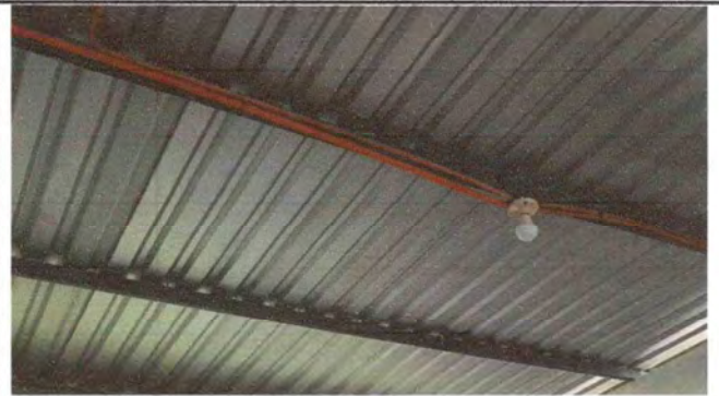
Foto 10 : sistema electrico instalado
