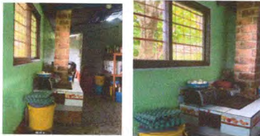
Foto 9: REPARACION O SUSTITUCION DE AREA DE COCINA.
