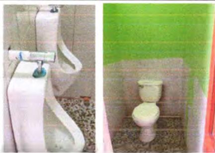
Foto 3: SERVICIOS SANITARIOS Y SUS ACCESORIOS (CAMBIO)
