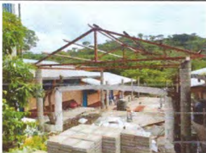
Foto 1: ESTRUCTURA DE TECHO (DESMONTAR, PINTAR Y AGREGAR TIJERAS)
