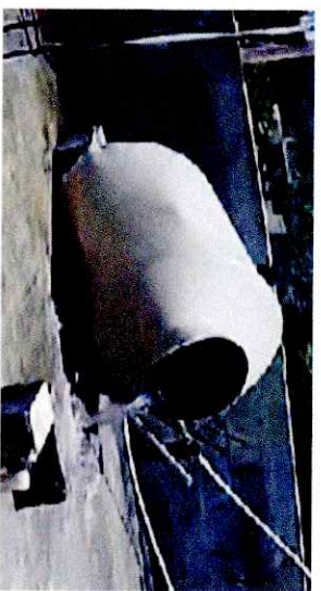
Foto 6: REPARACIÓN DE SITERNA (TIPO ROTOPLAS)
