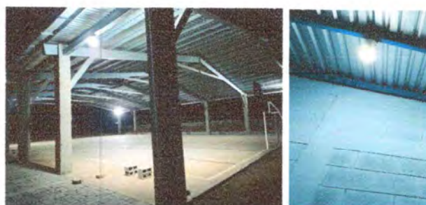
Foto 4: iluminación completa de las instalaciones afectadas.
