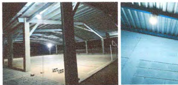
Foto 4: iluminación completa de las instalaciones afectadas.
