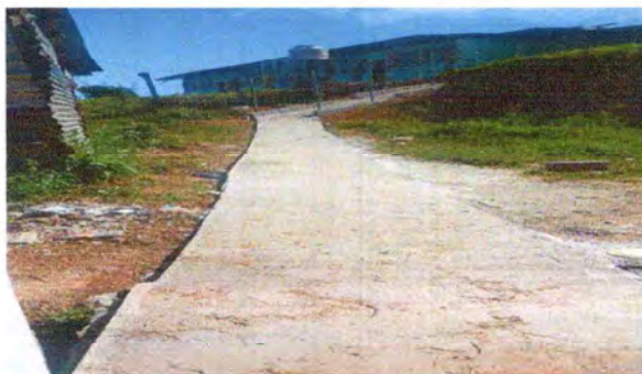
Foto1: Losa de patio en mal estado
