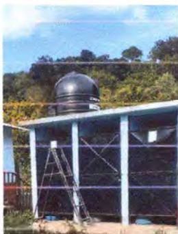
Foto 13: SUSTITUIR DE DEPOSITO DE AGUA
