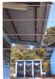
Foto 12: CANALES Y BAJADAS DE AGUA PLUVIAL (REEMPLAZAR)
