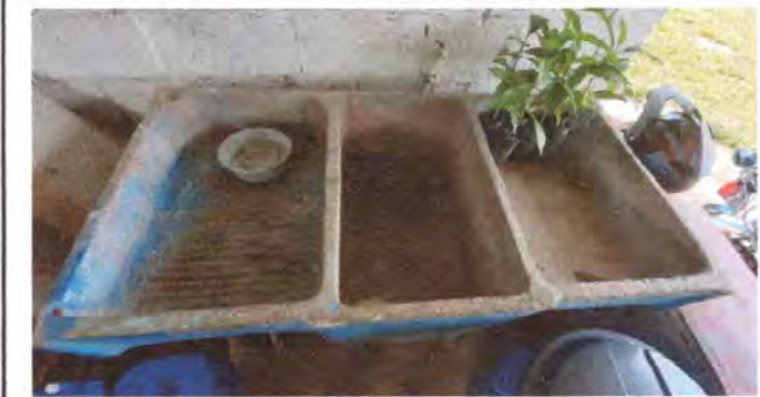
Foto 13: SUSTITUIR PILA (ÁREA DE COCINA). DEBIDO A DETERIORO, NO RETIENE EL AGUA LIMPIA Y DUCTOS DE DESECHO TAPADOS.
