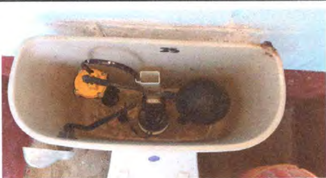
Foto 9: ACCESORIOS DE BAÑOS EN MAL ESTADO
