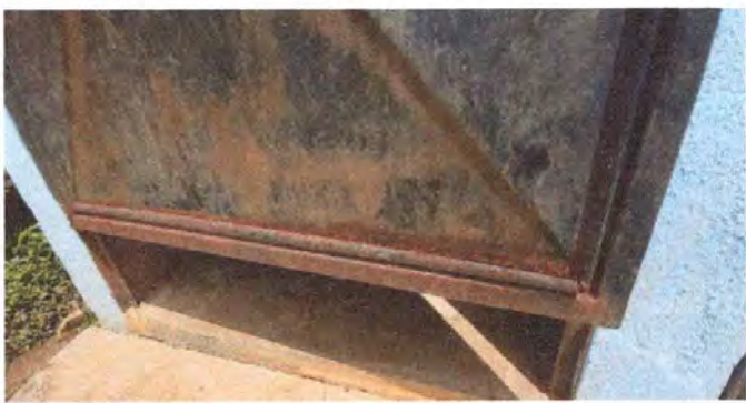
Foto 2: MANTENIMIENTO A PUERTAS DE BAÑOS (PINUTURA) DETERIORO POR CORROSIÓN.
