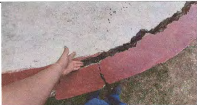
Foto 10: SE PUEDE APRECIAR LA SEPARACIÓN EN LOSA POR EL MAL ESTADO.
