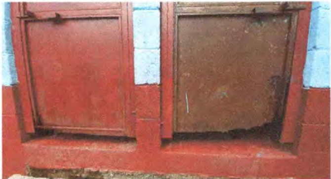
Foto1: ES NECESARIO REPARAR AMBAS PUERTAS DE LA MITAD HACIA ABAJO Y PINTURA
