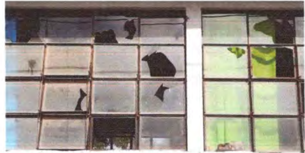
Foto4: se observa las ventanas rotas
