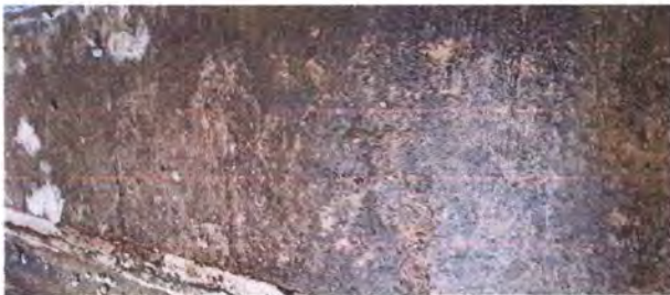
Foto7: se observa la losa de pario está en mal estado.
