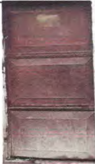
Foto3: se observa la puerta en mal estado
