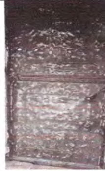
FOTO 2: Se observa la puerta en mal estado
