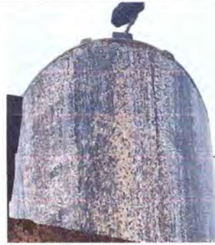
FOTO 8: Se observa el tinaco está en mal estado
