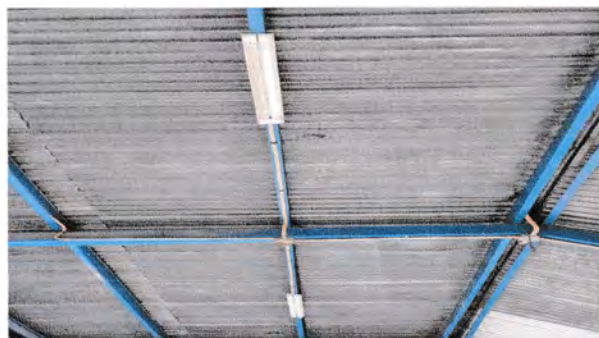
Foto3: Mala distribución de cables eléctricos.
