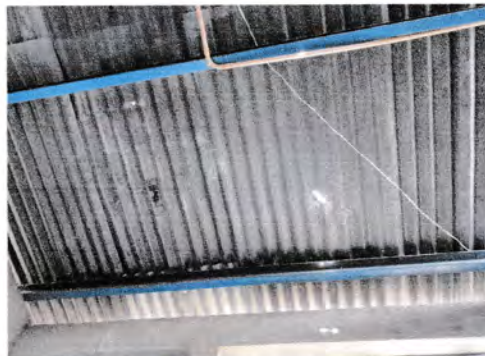
FOTO 2: Techo de lámina agujerada en mal estado.
