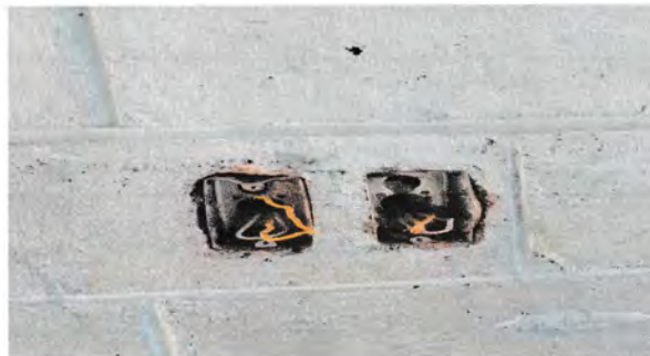
Foto: 6 Tomacorrientes en mal estado.
