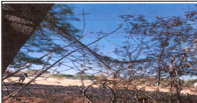
Foto 6: MALLA EN MUY MAL ESTADO
