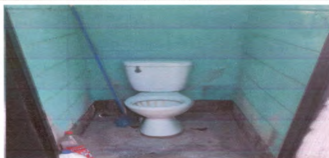
Foto 4: SANITARIOS EN MAL ESTADO
