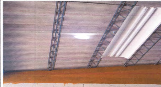
Foto 2: DURALITA EN MAL ESTADO
