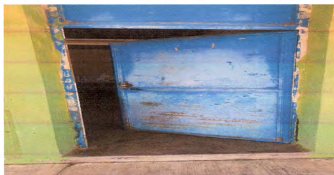
Foto 5: PINTURA DE PUERTAS EN MAL ESTADO
