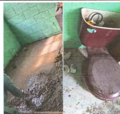
Foto 2: SERVICIOS SANITARIOS Y SUS ACCESORIOS
