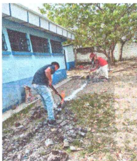
Foto 5: red de agua potable
