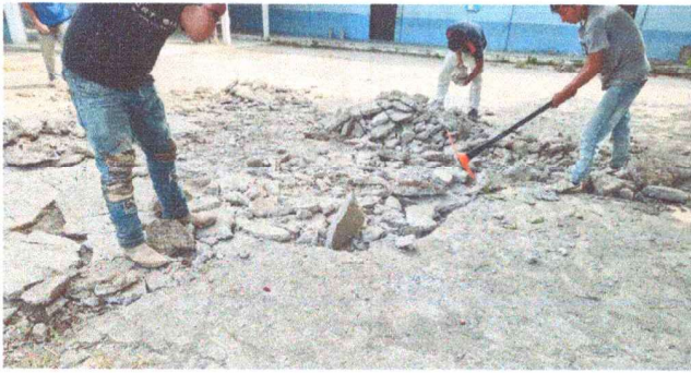
Foto 1: Losa de patio en mal estado
