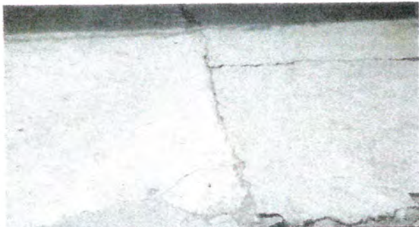
Foto3: Losa de patio en mal estado
