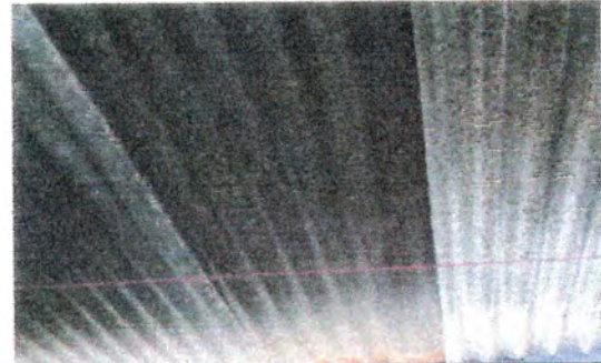
FOTO 2: Lamina en mal estado
