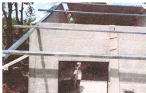
Foto 2: Estructura de techo reparado
