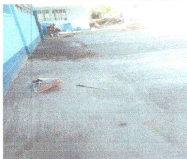
Foto 4: Losa de cemento
