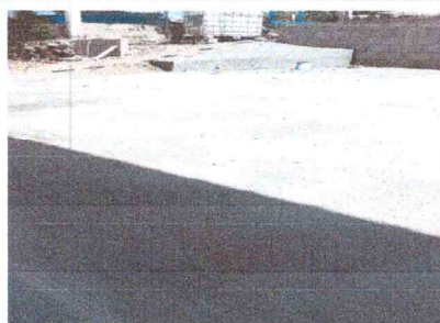
Foto 6: Losa de cemento
