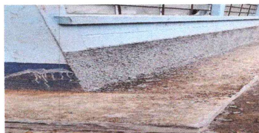
Foto 4: Granciado por problemas de exceso de humedad
