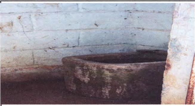
Foto3: inodoros en pesimas condiciones
