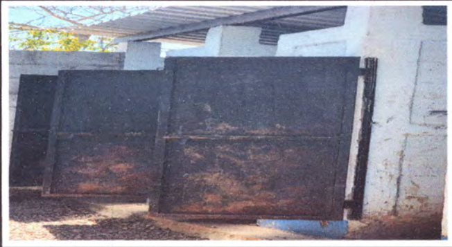
FOTO 2: necesidad de reparación de puertas
