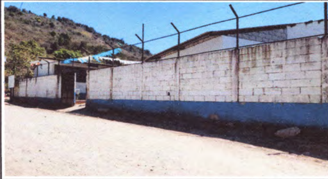
Foto1: paredes en mal estado
