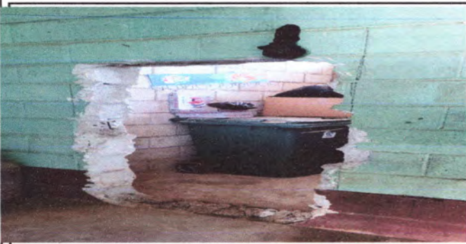
Foto: 5 pared requiere reparación
