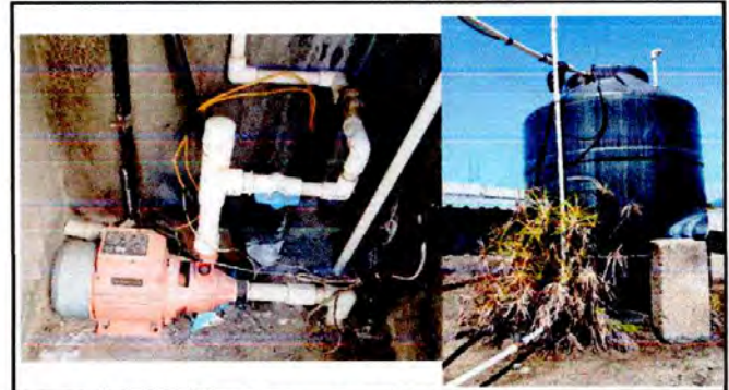
Foto 10: Cisterna y Bomba en mal estado
