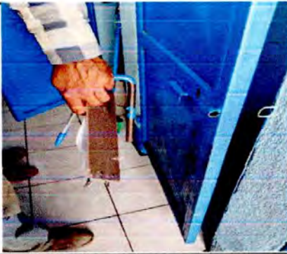
Foto 3: SE OBSERVA PUERTAS DAÑADAS
