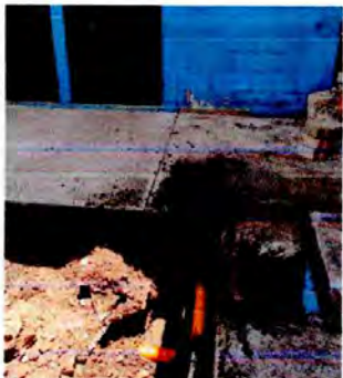
Foto 13: SE OBSERVA TUBERIAS DE DRENAJE DAÑADA
