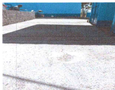
Foto 6: Losa de Cemento
