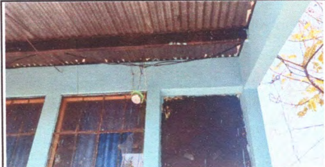
Mantenimiento del sistema Electrico
