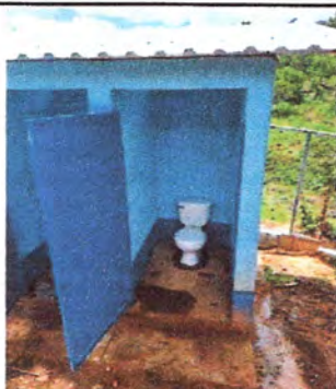
Foto: 5 Servicio sanitario y sus accesorios
