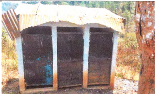
Foto1: cubierta de lamina de sanitario
