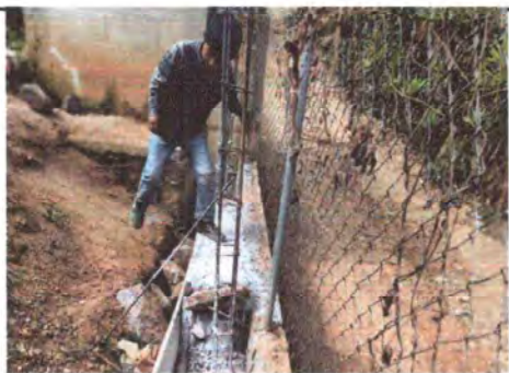
Foto 5: CERCO MURO PERIMETRAL EN MAL ESTADO
