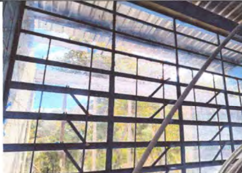
Foto 2: VENTANA EN MAL ESTADO.
