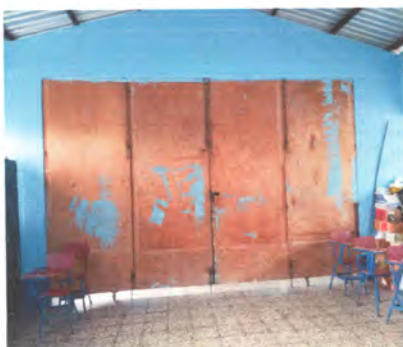
Foto 5: puerta de interior en mal estado
