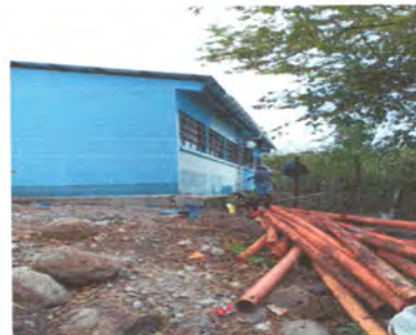
Foto 2: tubería quitada que estaba en mal estado
