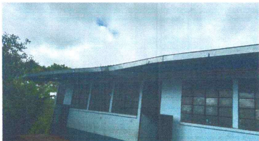
Foto 1: Canales en mal estado.
