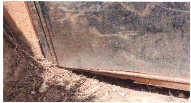
Foto4: PUERTAS EN MAL ESTADO
