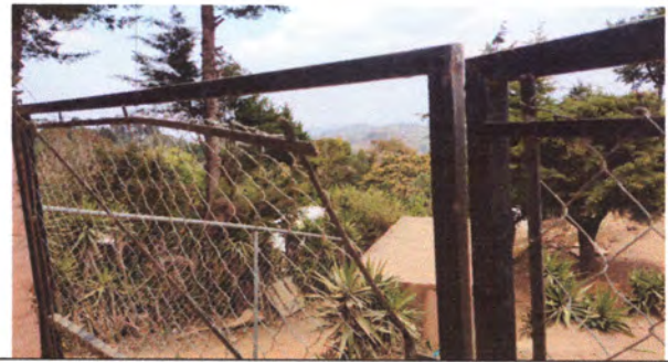
FOTO 2: PORTON EN MAL ESTADO
