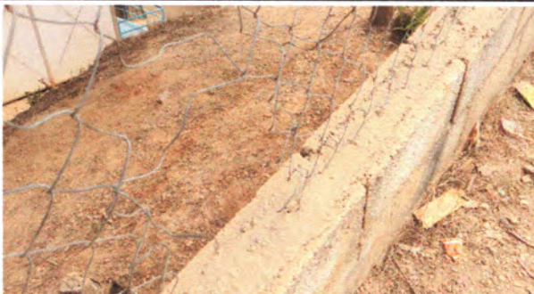
Foto: 5 MAYA DE CERCO EN MAL ESTADO
