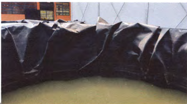
Foto3: SISTEMA DE AGUA EN MAL ESTADO
