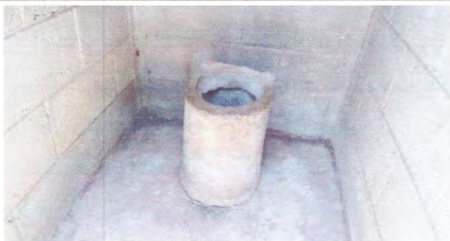
Foto 2: Sanitario, necesita cambiarlo.
