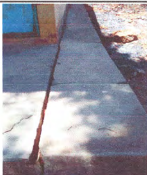
Foto 5: Banqueta en mal estado
