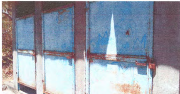
Foto 1: Puerta a reparar
