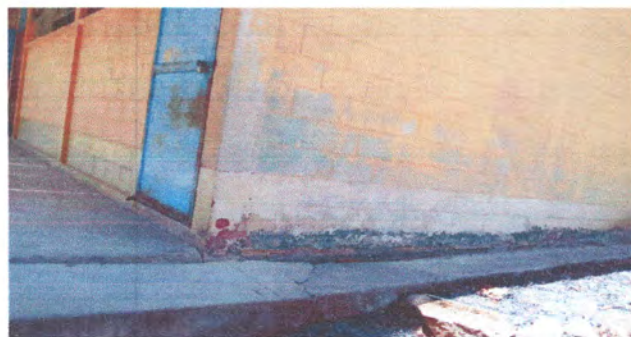
Foto 6: Banquetas en mal estado.
