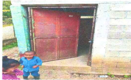
PUERTA DETERIORADA Y MAL COLOCADA
