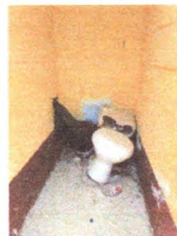
Foto4: Se observo taza de servicio sanitario en mal estado
