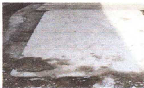
FOTO 2: Se observo losa de patio en mal estado
