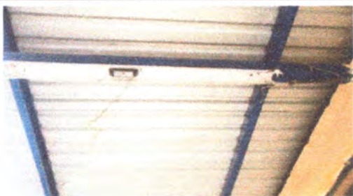
Foto3: Se observo fuentes de energia y cableado en mal estado
