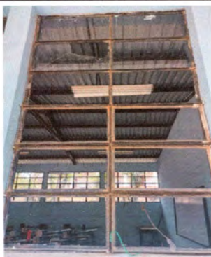
Foto3: Se evidencian vidrios rotos
