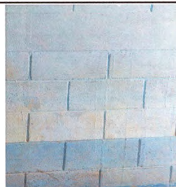
Foto4: Se observa paredes con pintura deteriorada
