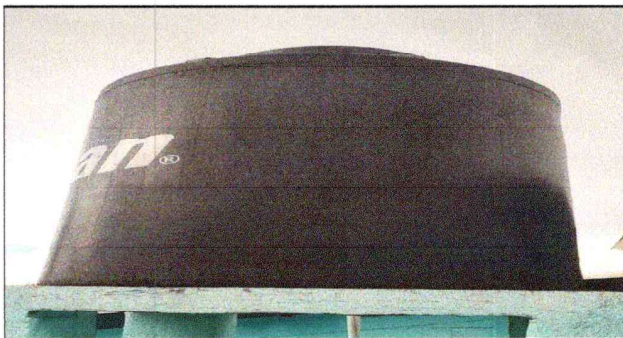
Foto 6: SE OBSERVA ROTOPLAS INSTALADO
