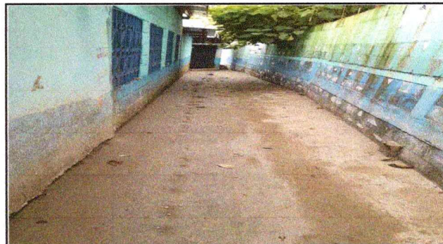
Foto 4: ES NECESARIO UNA CUNETETA DE CONCRETO
