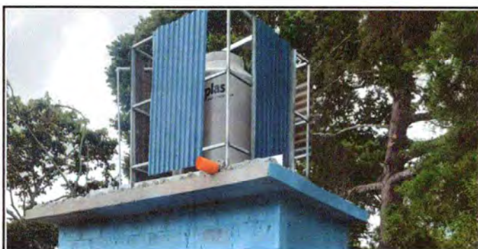
Foto 5: DEPOSITO DE AGUA INSTALADO.
