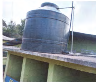
Foto: 6 El rotoplas tiene fuga de agua.
