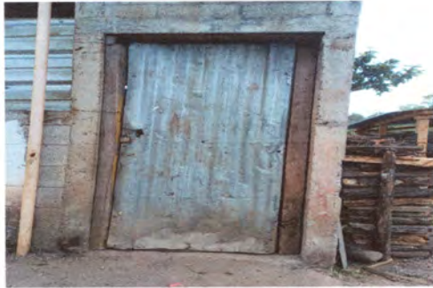
Foto1: Se observa a simple vista que las puertas se encuentran en mal estado.
