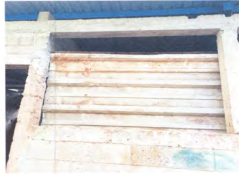
FOTO 2: Se observa que las ventanas estan en mal estado.
