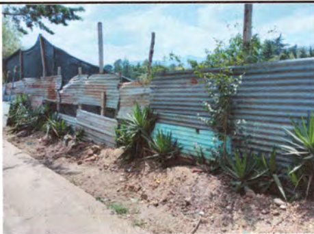
Foto: 5 Se observa el muro perimetral en mal estado
