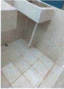
Foto7: REPARACION O SUSTITUCION AREA DE COCINA (pilas con filtracion)
