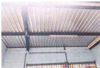
Foto1: Sustrucción de Lamina en buen estado
