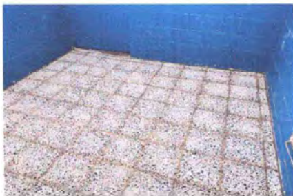
Foto3: Sustrucción de piso en buen estado
