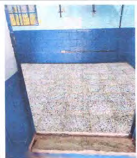
Foto3: Sustrucción de piso en buen estado
