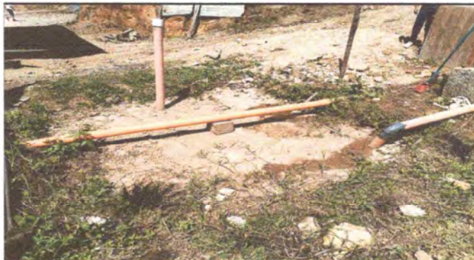
Foto 10: Sanitarios: Fosa séptica.
