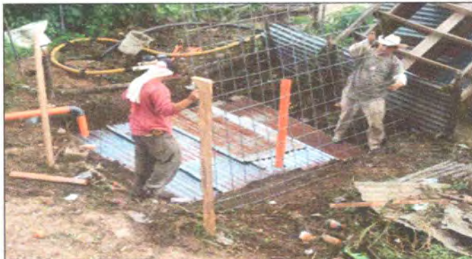
Foto 10: Sanitarios: Fosa séptica.
