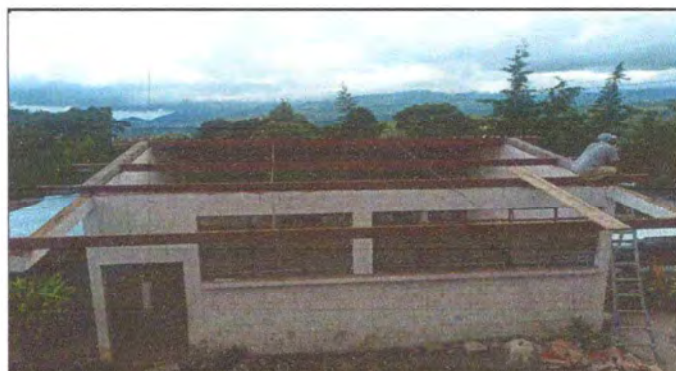
Foto 4: Estructura de techo (Pintura): Salón ubicado en el Entrada del Centro Educativo
