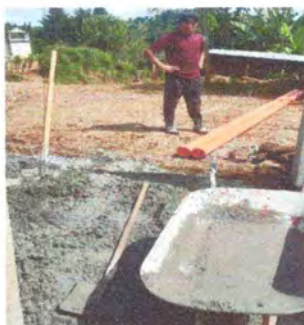
Foto 2: Cuneta para que fluya el agua de lluvia.
